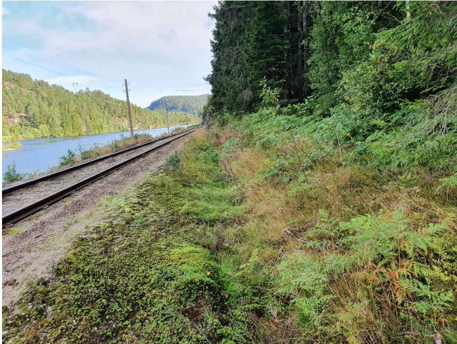
Linjegrøft med behov for vedlikehold. Bilde er tatt sørover fra ca. Km 352,350
