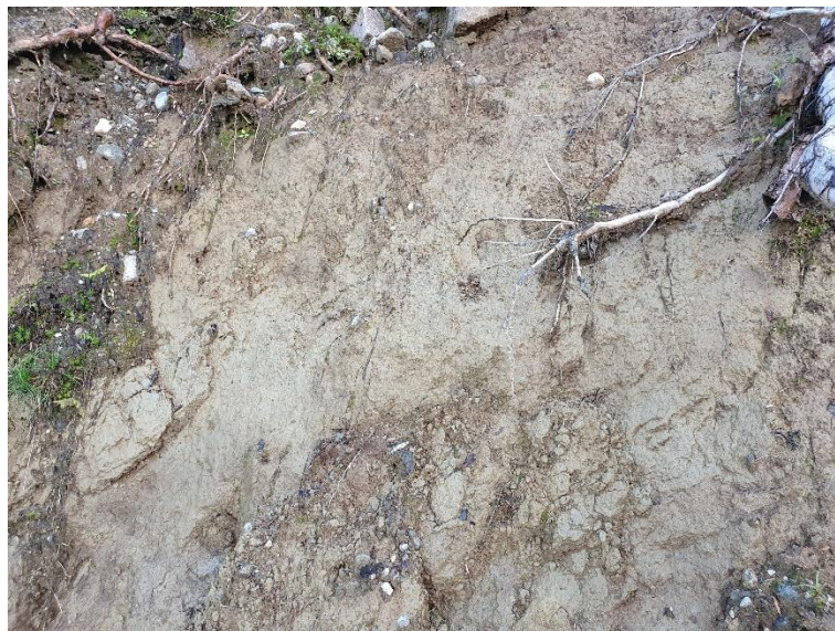
Siltige masser som er blottlagt i erosjonsskaden. Bildet er tatt på den tørreste tiden sommeren 21
