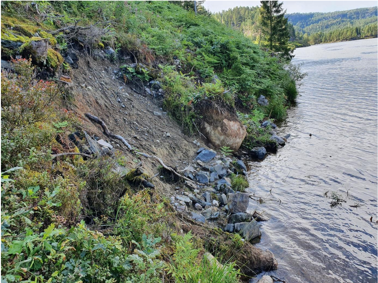
Erosjonsskade ved ca. Km 352,350
