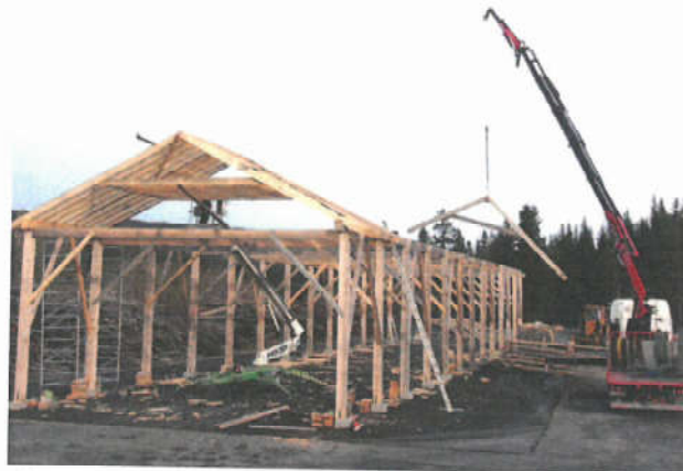
Alle grinder er heist på plass. Takstolene monteres med kran. Det er skåret hakk i stavleggerne som passer for sperrene.
