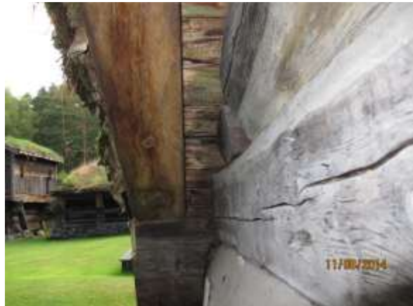
Takutstikk nord/øst, råteskader
