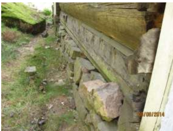
Grunnmur nord/øst, glir ut
