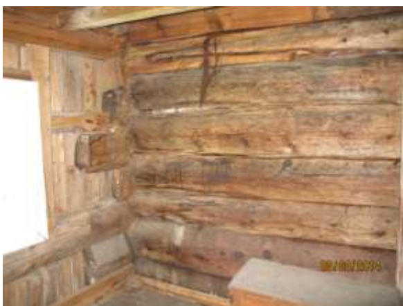
2. etasje gang rundt pipe gammel vannskade
