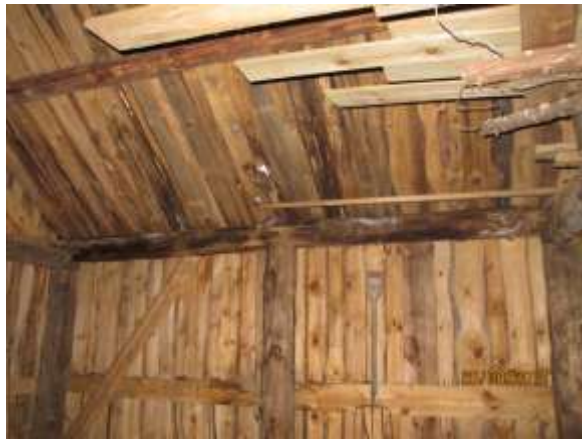
Sørvegg dårlig toppsvill
