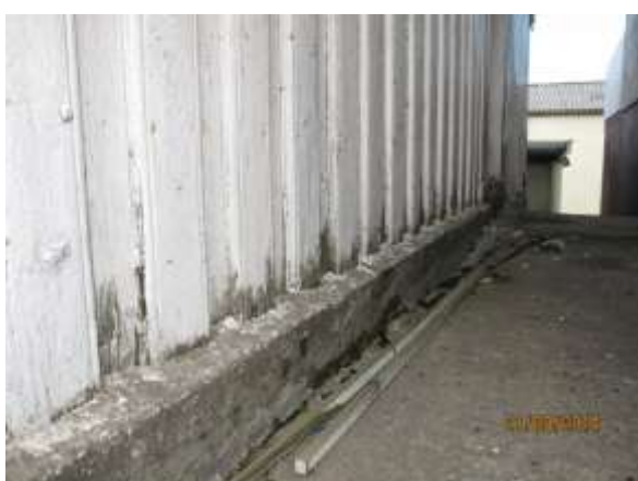
Østveggen. Dårlig løsning lite lufting til kledning. Råte i underkant
