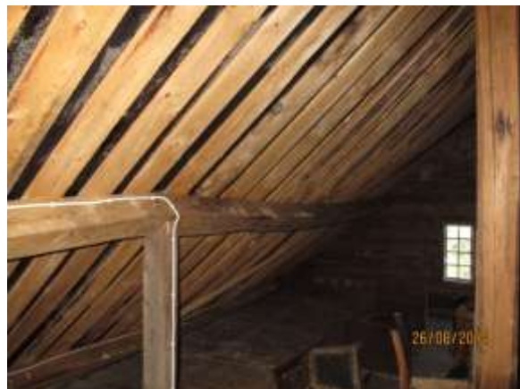
Loft, ås noe nedbøyd (Underdimensjonert)
