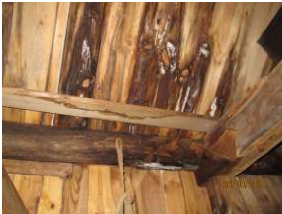
Toppsvill og tak nordvegg
