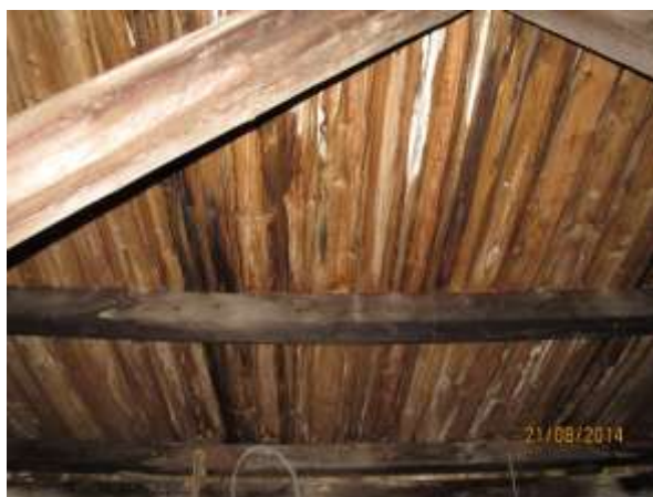
Tak tilbygg dårlig, lekkasje
