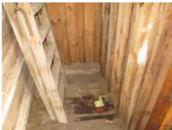
Dårlig gulv i svalgang
