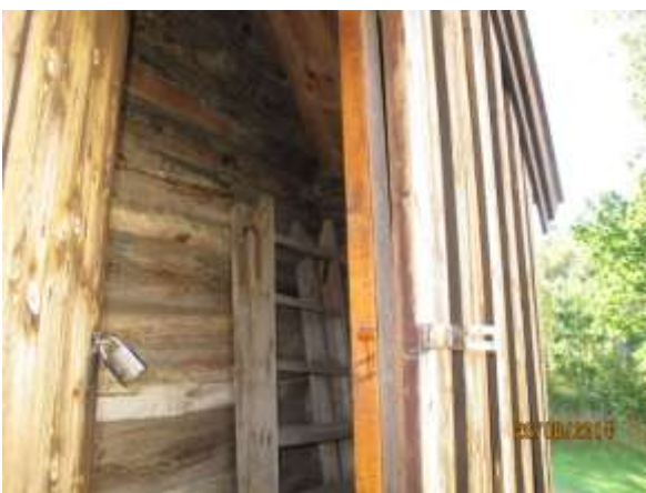
Dørkarm ødelagt etter innbrudd
