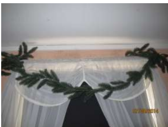
Sopp vegg, stue vest 2 etasje
