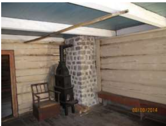
2. etasje stue nord gammel vannskade
