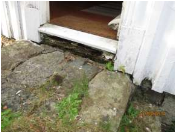
Råte i svill dør øst
