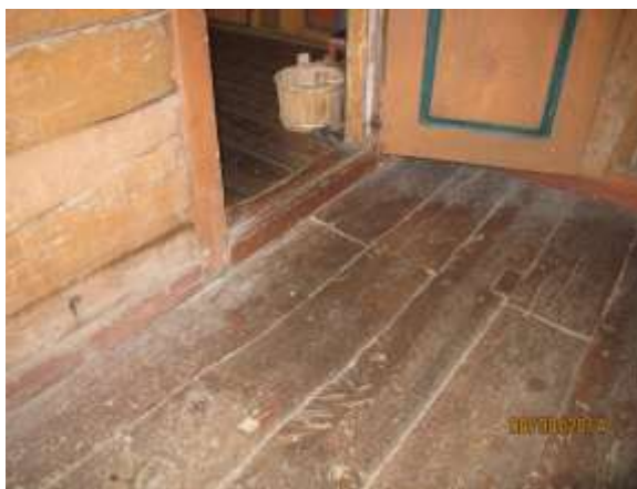
1. etasje mot stue nord, gulv noe dårlig
