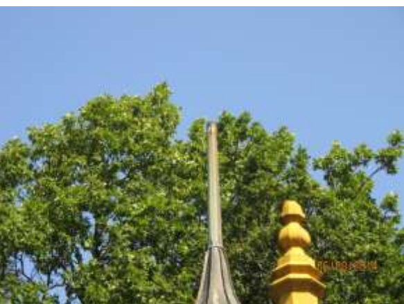
Spir. Mangler toppkorset
