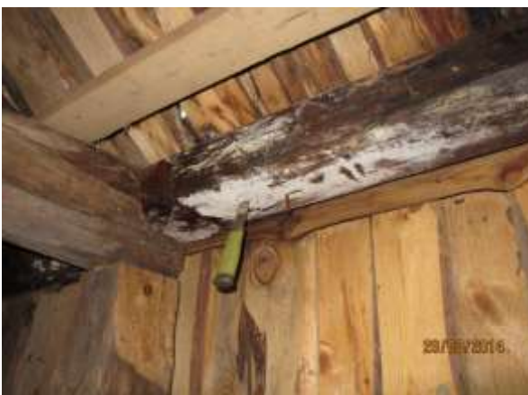
Store råteskader i toppsvill nordvegg
