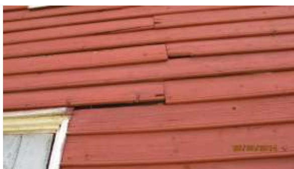
Vestveggen mye dårlig kledning
