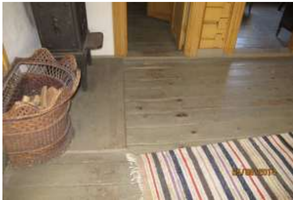
Dårlig gulv ved ovn i 2. etasje
