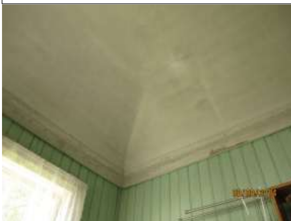
Innvendig tak skittent
