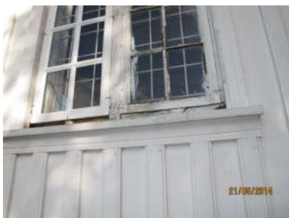
Ny restaurert vindu som mangler bunnkarm til venstre, høyre vindu behov for restaurering
