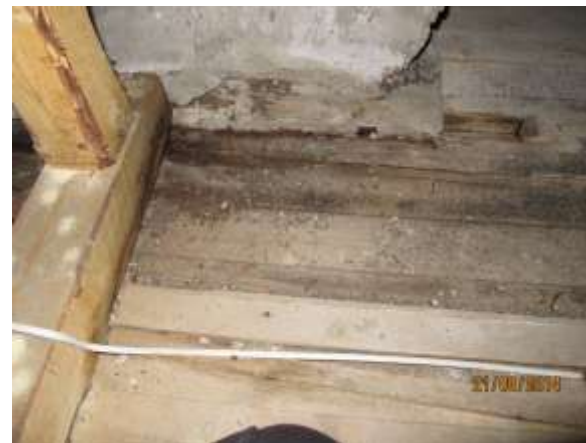
Ved pipe loft lekkasje ved pipe
