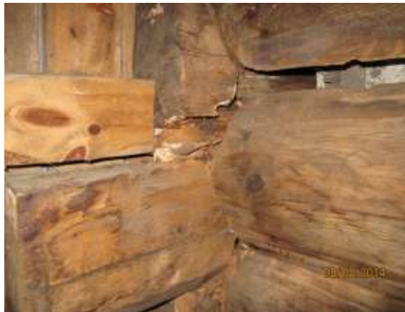
2. etasje gang rundt pipe gml. vannskade
