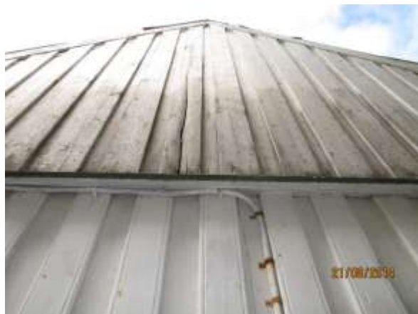
Østveggen, dårlig kledning
