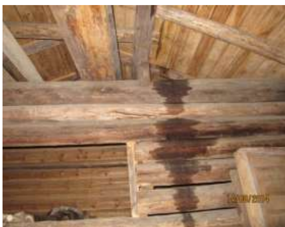
Søndre rom, lekkasje
