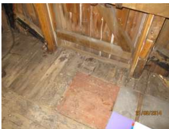
Dårlig gulv 2. etasje
