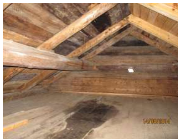
Loft over stue 2. etasje sør. Vannlekkasje
