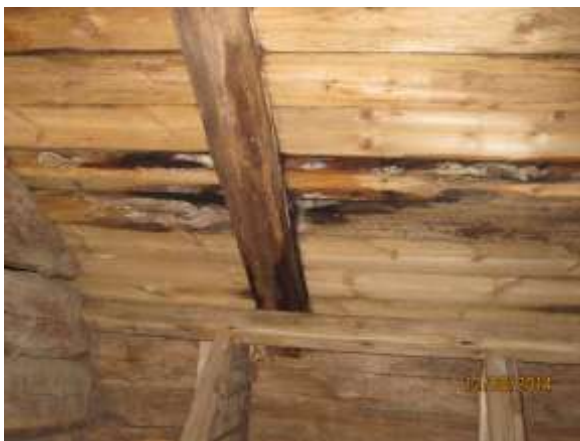
Råteskade etter lekkasje
