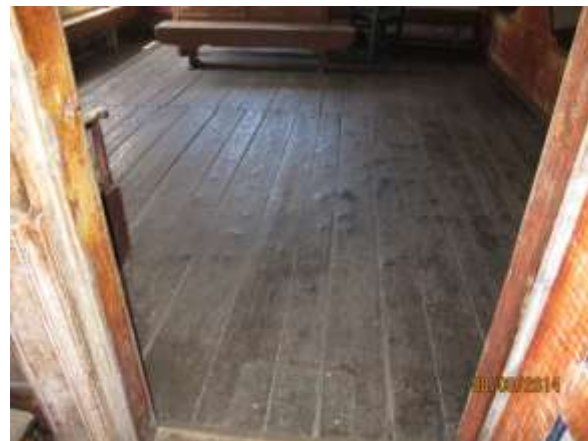
2. etasje stue nord, slitt gulv
