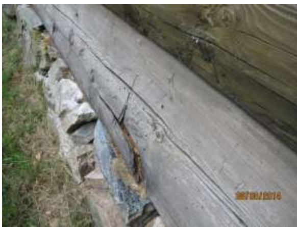
Svillstokk fra sørveggen rått
