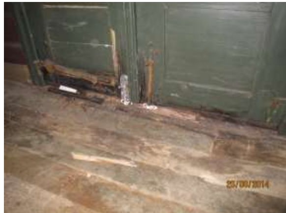
Ytterdør vest og gulv dårlig/råteskader
