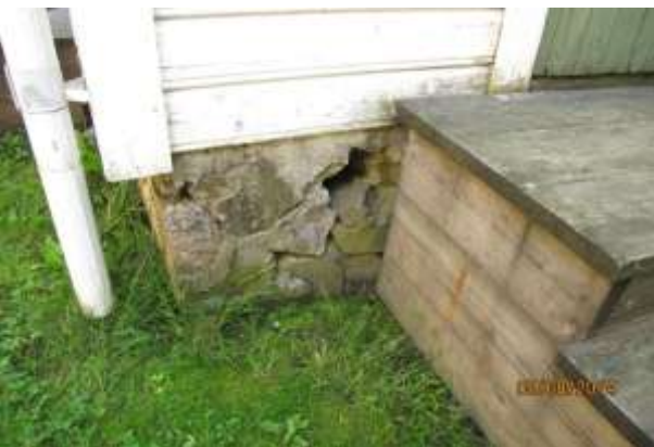
Mangler ventil i grunnmur, nord
