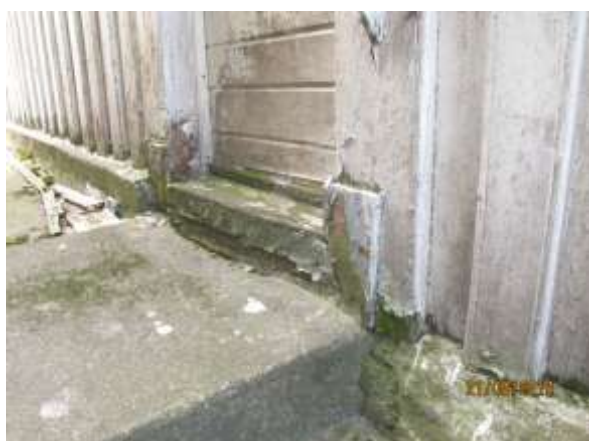
Fra østveggen. Råte under/ved dør
