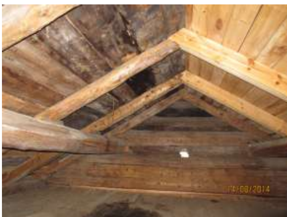
Loft sør lekkasje
