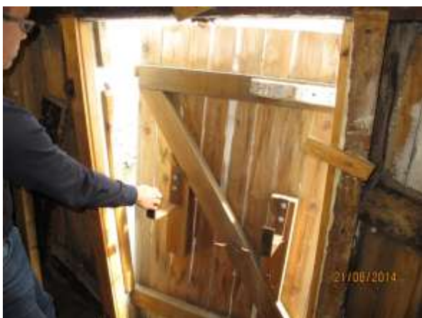
Dårlig dør 2. etasje
