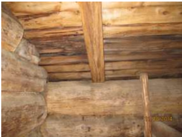
Råteskade tak mot nord/øst
