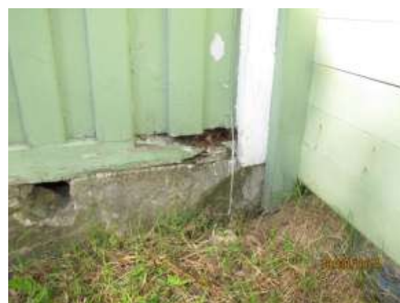
Dårlig bunnsvill østveggen
