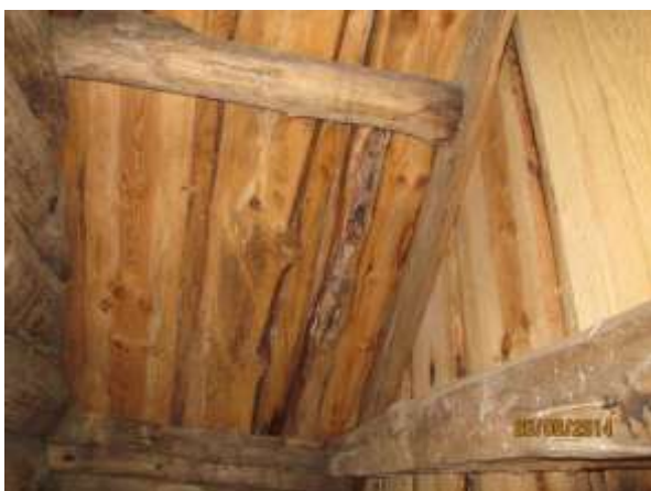
Tak innvendig dårlig/råte
