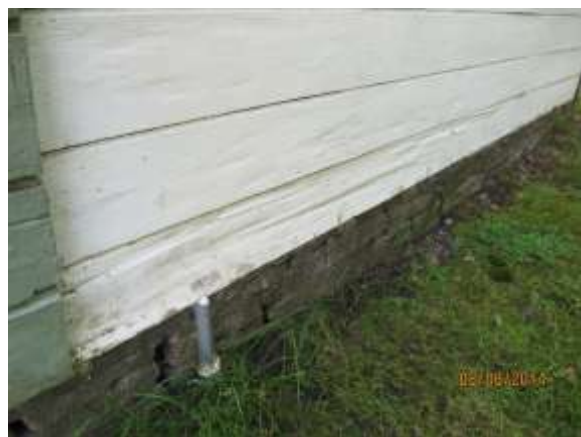
Vest vegg, råteskader
