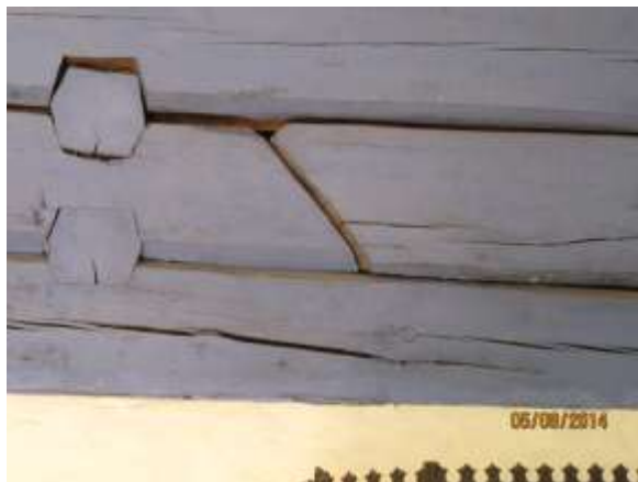
Setningsskader laft i kramboden
