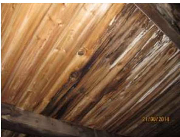
Tak tilbygg dårlig, lekkasje
