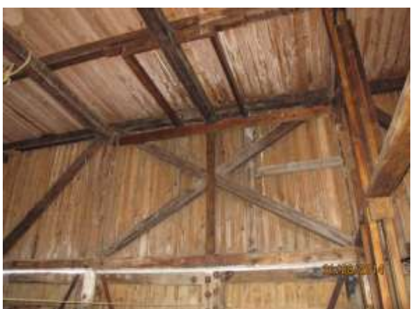
Gulv /tak fra 1. etasje mot sjøen, dårlig
