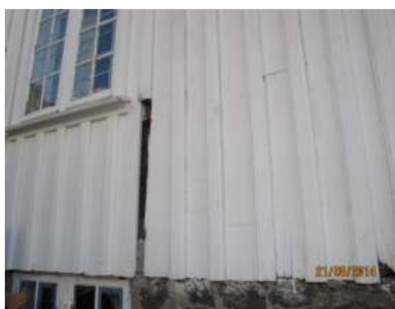
Manglende påbord på nordveggen
