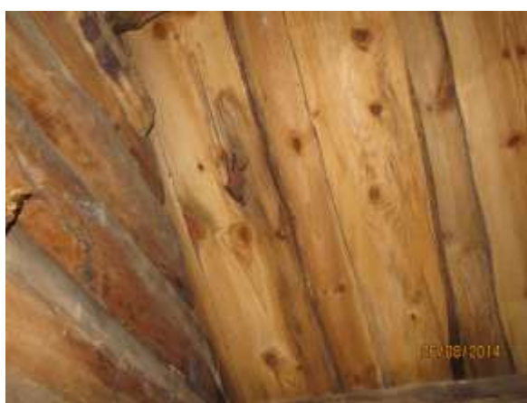
Tak innvendig dårlig/råte
