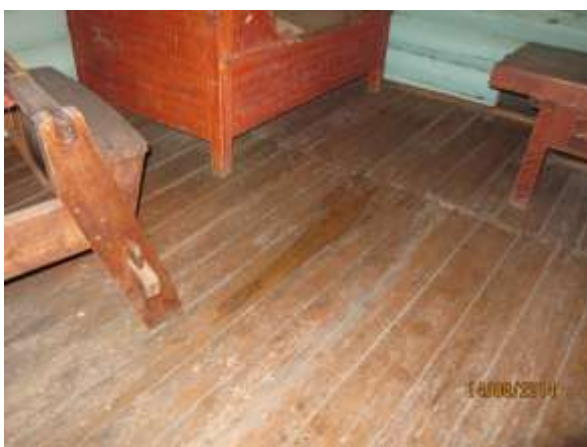
2. etasje stue sør vann på gulv etter lekkasje
