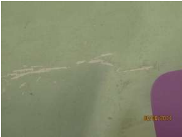
Skade på vegg
