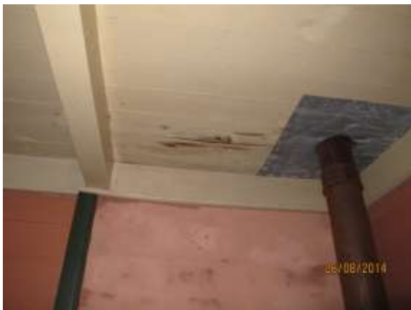
Råteskade tak 2. etasje stue sør/vest
