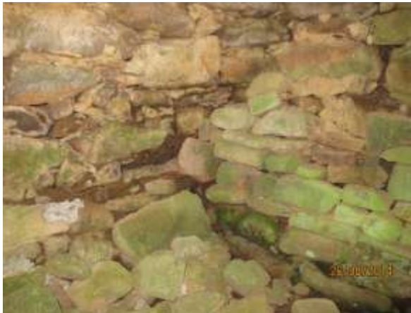
Innvendig stein fra vegg rast ut
