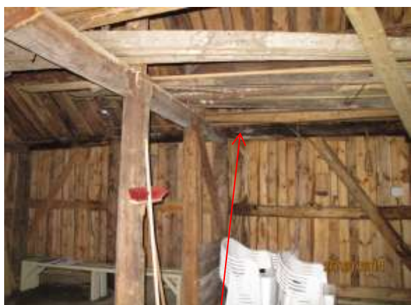
Dårlig og råttent toppsvill pga taklekkasje nordvegg
