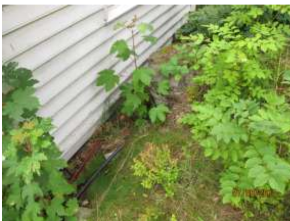
Sørveggen. Kledning mot bakken, må graves
