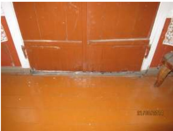
Litt råte i gulv ved dør vest
