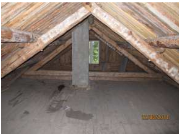
Loft mot nord. Lekkasje ved pipe
