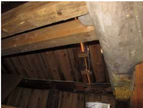
Sørvegg dårlig tak
