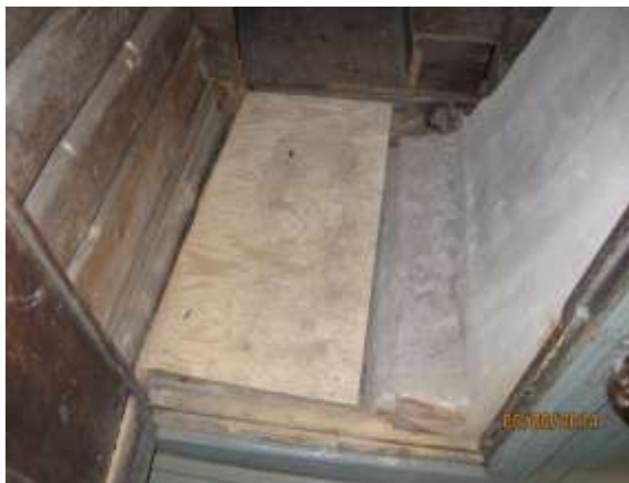
Dårlig gulv 2 etasje mot loft
