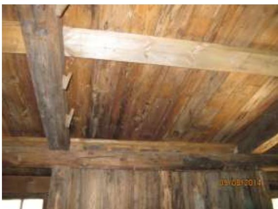
Innvendig tak, lekkasje
