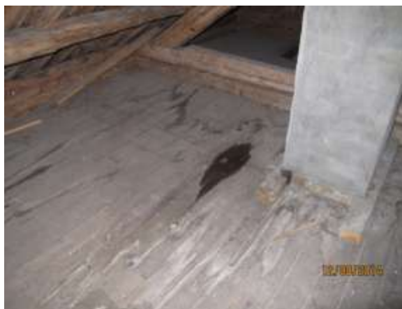
Lekkasje ved pipe
