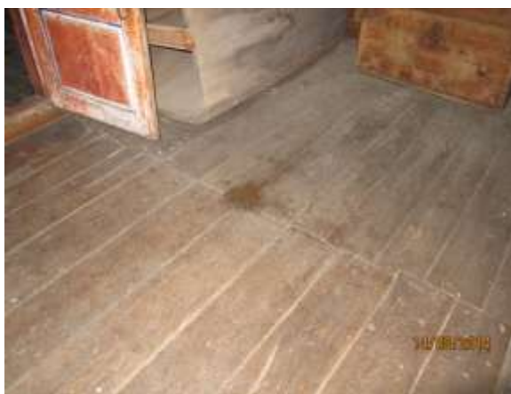
Liten lekkasje midtgang 2 etasje
