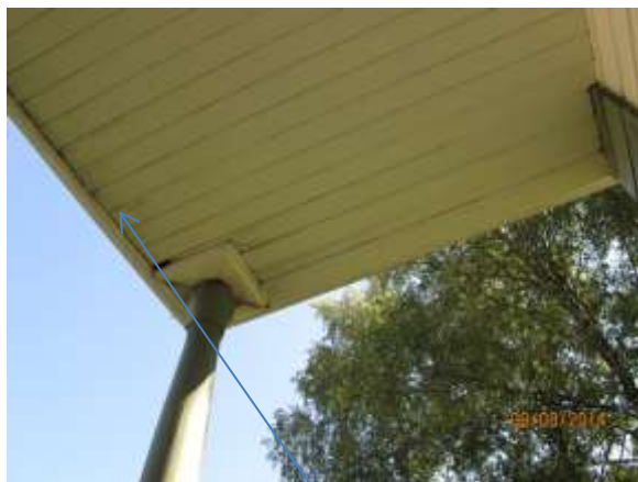
Manglende list i taket utvendig
