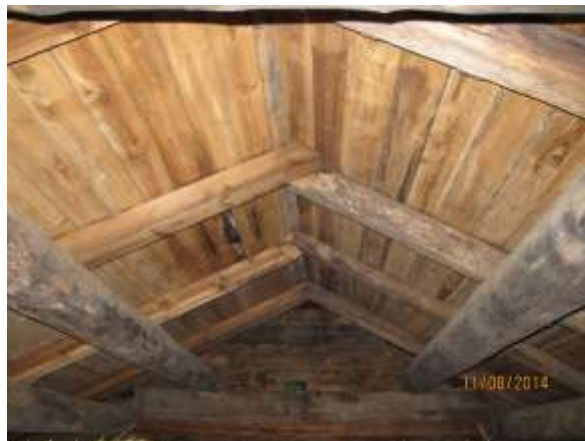
Råteskade etter eldre lekkasje.
