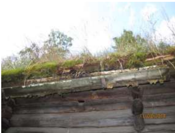
Takrenne og torvollstokk/kroker dårlig
