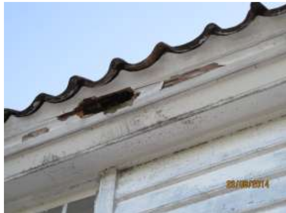
Råteskade pannebord vestveggen
