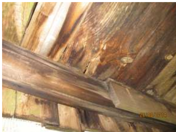
Råttent gulv i svalgang
