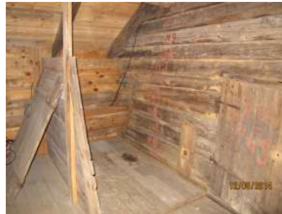
Liten lekkasje i stall
