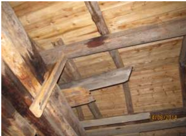
Taklekkasje nordre rom
