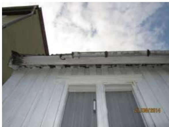
Nordveggen, dårlig pannebord og takrenne
