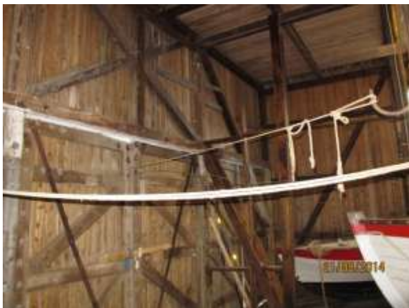
Vegg mot sjø (Syd) dårlig
