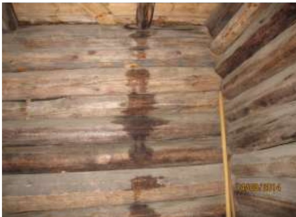
Taklekkasje nordre rom
