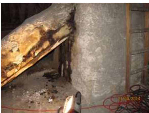
Pipe i loft, må sjekkes og restaureres
