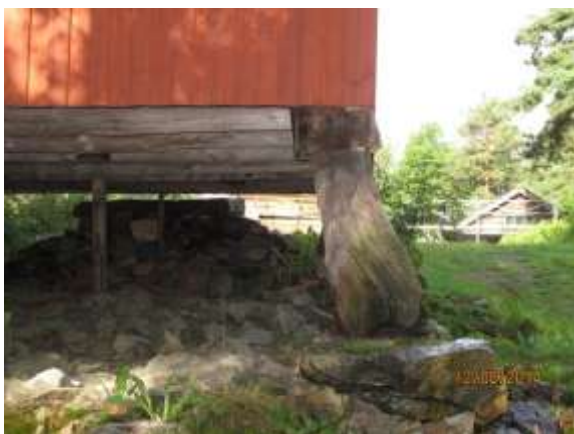
Stabber må kontrolleres/skiftes
