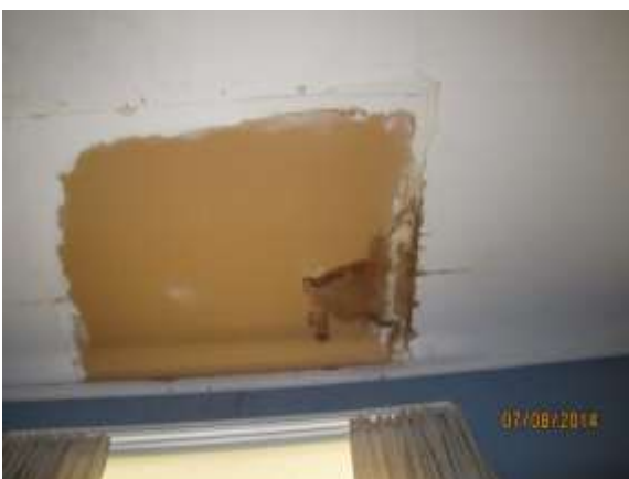
Tak, stue øst 2 etasje. Fra gammel vannskade i kilrenne
