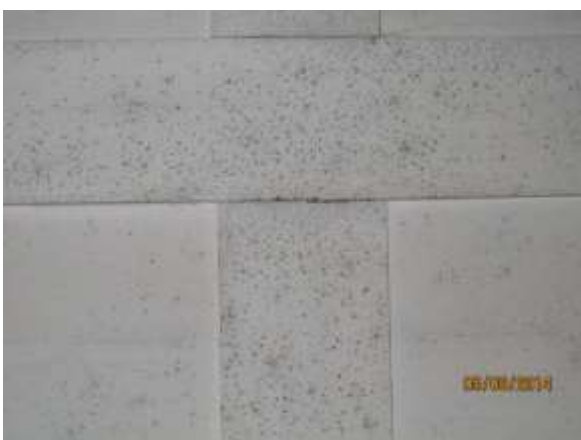
Svertesopp i tak 1 etasje
