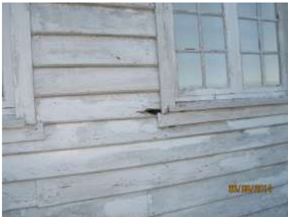
Vestveggen dårlig kledning og belistning
