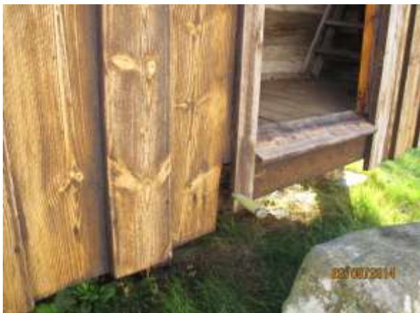
Dårlig bunnsvill ved dør
