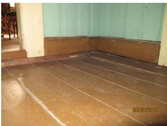
Setningsskader 1 etasje gulv/dørlist
