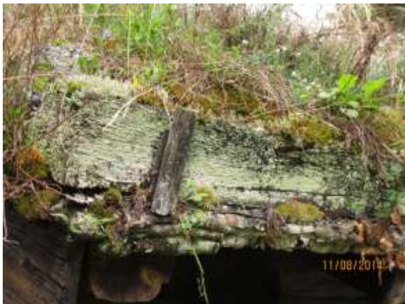
Dårlig torvollstokk og kroker
