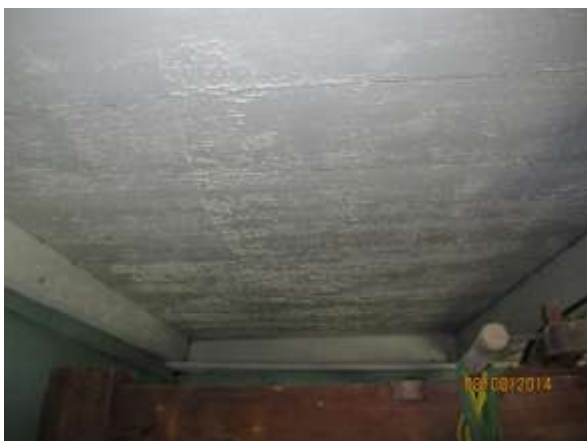
2. etasje stue sør tak bør males
