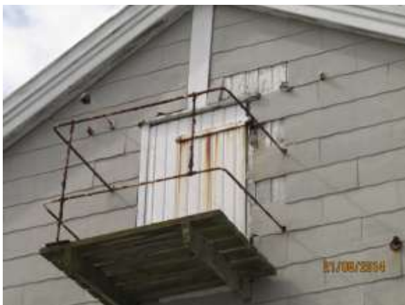
Dårlig rekkverk 2 etasje
