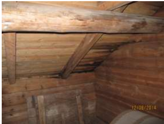
Taklekkasje, sør vest
