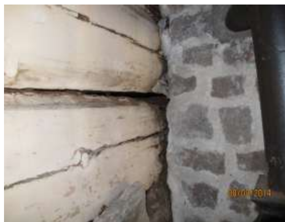
2. etasje stue nord gammel vannskade
